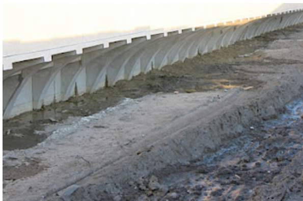
美麗灣圍籬內的天然海沙已經毀了，混合著工地廢土與施工物質，混合廢棄土的沙子乾掉則會結成硬塊。
