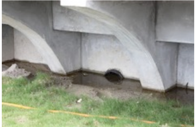
走近一看 持續排著不明水，直接排入沙灘裡溢流
