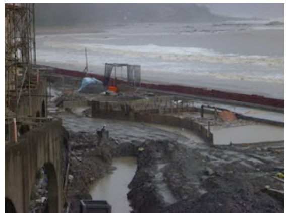
工地淹水，污水直接排入沙灘!
